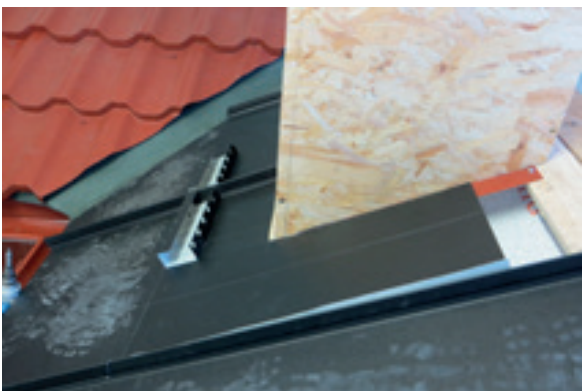
Obr. c – po odstrihnutí vonkajšej hrany zámkov prvej šablóny krytiny Classic v mieste priečného preloženia s druhou šablónou, sa šablóna uchyť nerezovými skrutkami a osadia sa vetracie profily.
